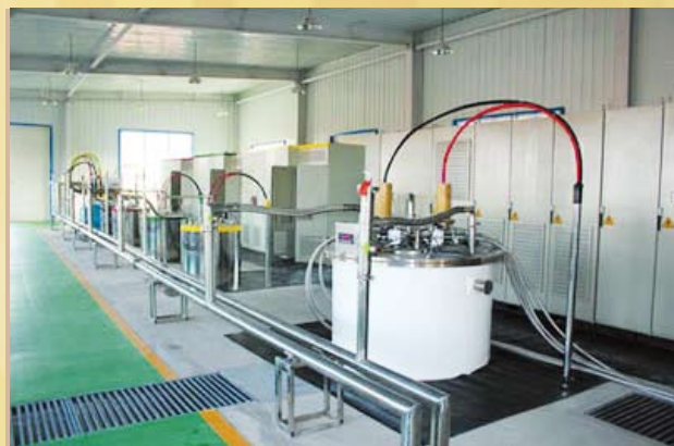
首座超导变电站
